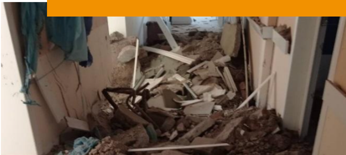
Зруйнований кабінет «Довіра», Авдіївка
